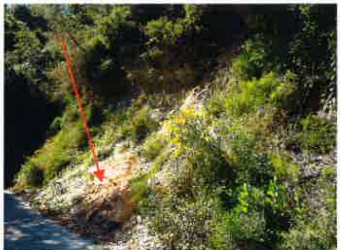
Photo 2 : Zone éboulée en bord de route : vallon du Terron
