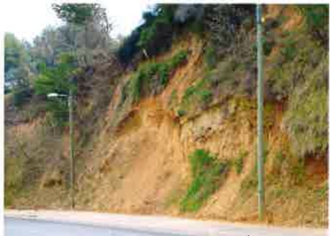
Photo 6 : Talus dans les limons quaternaires glissés : chemin Ginestière
