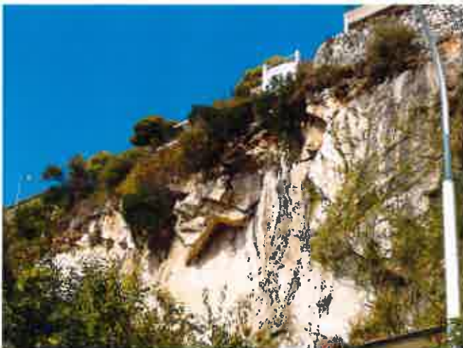
Photo 1: Zone potentielle de départ d'éboulement : quartier Maeterlinck
